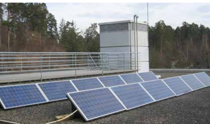
Det Norske Veritas - nettilknyttet solcelleanlegg på 1,8 kW
